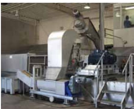
TRI ET BROYAGE DE DÉCHETS ALIMENTAIRES EMBALLÉS SUR PLUSIEURS SITES D'UNE ENTREPRISE DE RECYCLAGE LEADER SUR SON MARCHÉ.
